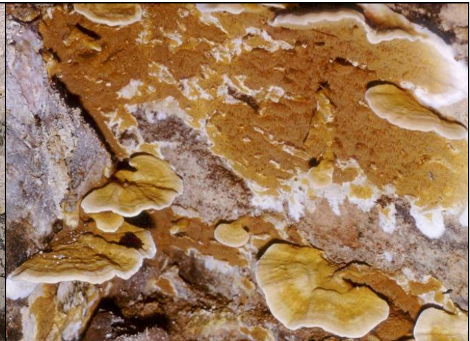
Abb. 13: Konsolenförmige, zimtbraune Fruchtkörper des Echten Hausschwammes ( Serpula lacrymans ) an einer Drepelmauer; die Fruchtschicht liegt auf der Hut-Unterseiten; auf der Oberseite liegt Sporenstaub.
