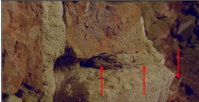
Abb. 10: Stränge des Echten Hausschwammes in den Fugenspalten und Ritzen des Mauerwerks (↑); der Putz wurde abgestemmt.
