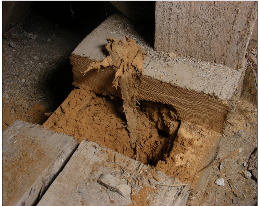
Abb. 7: Stränge und lappiges, braun-graues Mycel des Echten Hausschwammes im Inneren eines Mauerbalkens (Innenfäule). Der Balken war dreiseitig ohne erkennbaren Schaden und klang nicht hohl. Das Innere zeigt eine massive Innenfäule (Braunfäule); Begleitschaden durch den Balkenkopf-Pochkäfer / Schwammholzkäfer ( Trypomyces carpini ).
