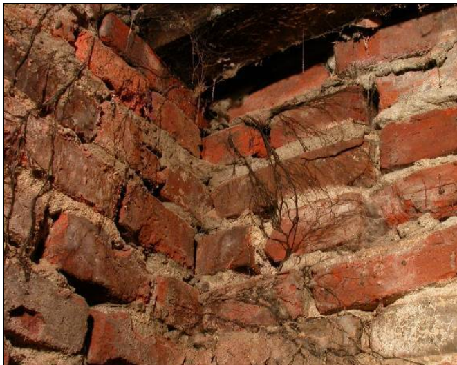
Abb. 5: Dunkle Stränge des Braunen Kellerschwammes ( Coniophora puteana ) wachsen am Mauerwerk und durchwachsen es.
