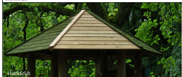
Abb. 5: Die Brettstöße sind zwar abgedeckt; trotzdem können besondere Klimate (z. B. Dauerschatten unter Bäumen) zu Schäden führen (siehe reparierter Bereich).
