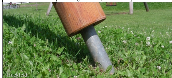
Abb. 4: Pfeiler vom Untergrund entkoppelt; Abtropfnase nicht sichtbar.
