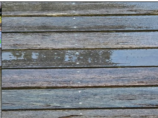
Abb. 12: Werden die Terrassen-Dielen, so verlegt, dass sie bei Befeuchtung nach oben „schüsseln“ kann eine längliche Pfütze entstehen.
