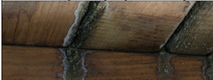
Abb. 9: Die Terrassen-Unterseiten zeigen ggf. die Schwachstellen der Konstruktion (hier: Holz an Holz-Verbindung). Die Knotenpunkte werden bei Regen nass – Pilzbefall droht. Zudem sind die Spalten zu schmal: Gut sind 7-10 mm Breite.
