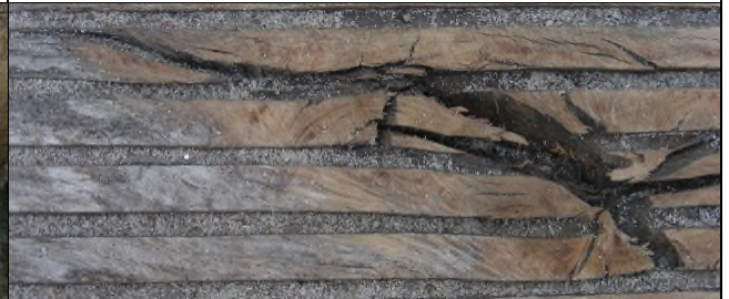
Abb. 10: Grobe Risse aufgrund von Holzfehlern können und sollten durch richtige Holz Auswahl vermieden werden; diese Bereiche neigen zum Splintern.
