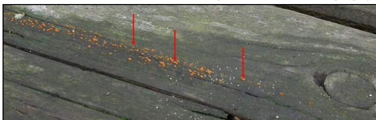
Abb. 1: Übersicht: Gallertränen-Fruchtkörper ( Dacrymyces sp.) an einem Brückenbelag – Braunfäule nur am Splintholz, das Kernholz ist intakt.
