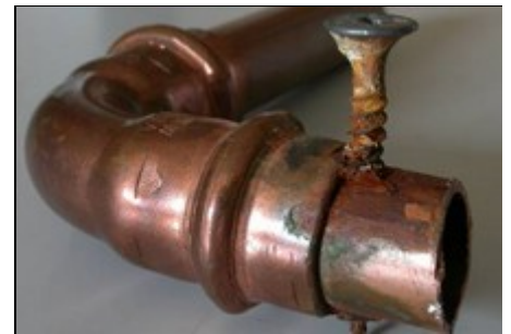
Abb. 1: Handwerker-Pech: Leck an einem neuen Heizungsrohr, das sich erst mit der Zeit öffnet.
