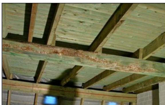
Abb. 4: In der Bauphase nass gewesene Balken; diese wurden von Schimmel-, Bläue- und Rotstreifepilzen bewachsen; die Feuchte konnte schnell genug abtrocknen, Trockenrisse, die zum Tränkzeitpunkt nicht vorhanden waren, bildeten sich.
