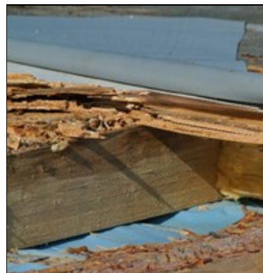
Abb. 3: „Eingepackte“ Konstruktionen in einem Flachdach (Warmdach) mit Schaden durch Hausfäulepilze; eine Braunfäule ist am Balken und Schalung erkennbar. In diesen Fällen reichen kleine Wassermengen aus, um größere Schäden zu verursachen.
